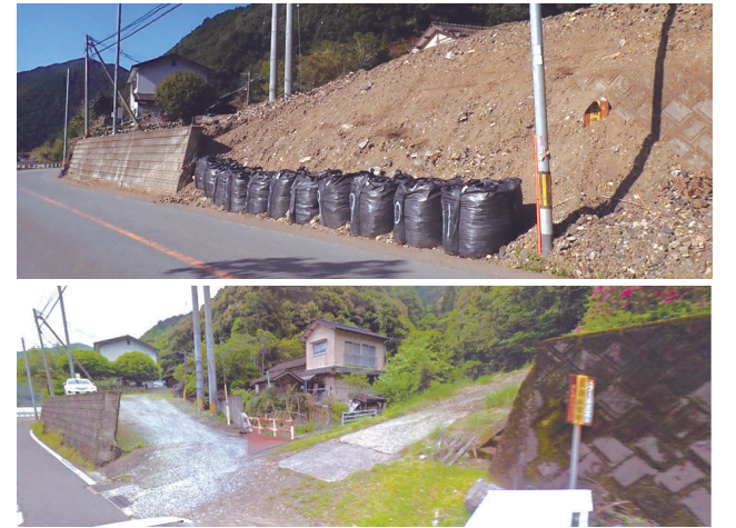
図-5 瀬戸石ダム上流の被災集落(被災後と被災前)
