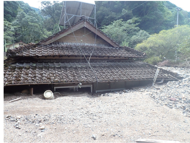
図-4 瀬戸石ダムの影響を受けた多武除集落の家屋被害
