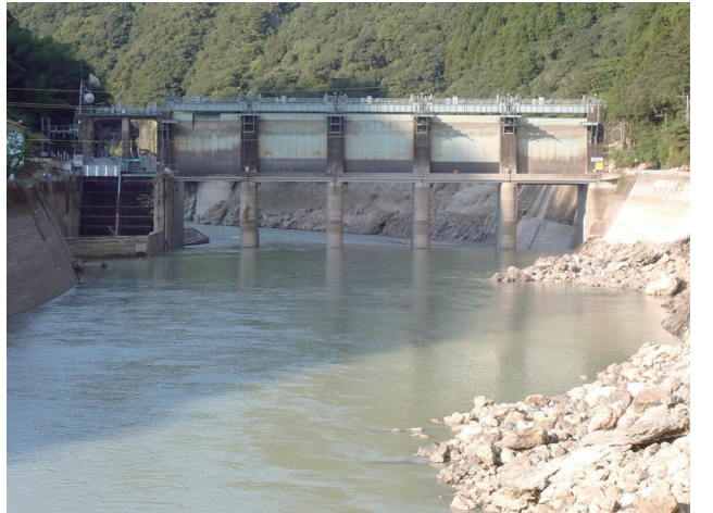
図-9 流れを阻害した瀬戸石ダム
