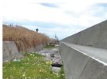
堺7-3区北端部の護岸 右側がすぐ海で荒天時には越波により海水が入る。
