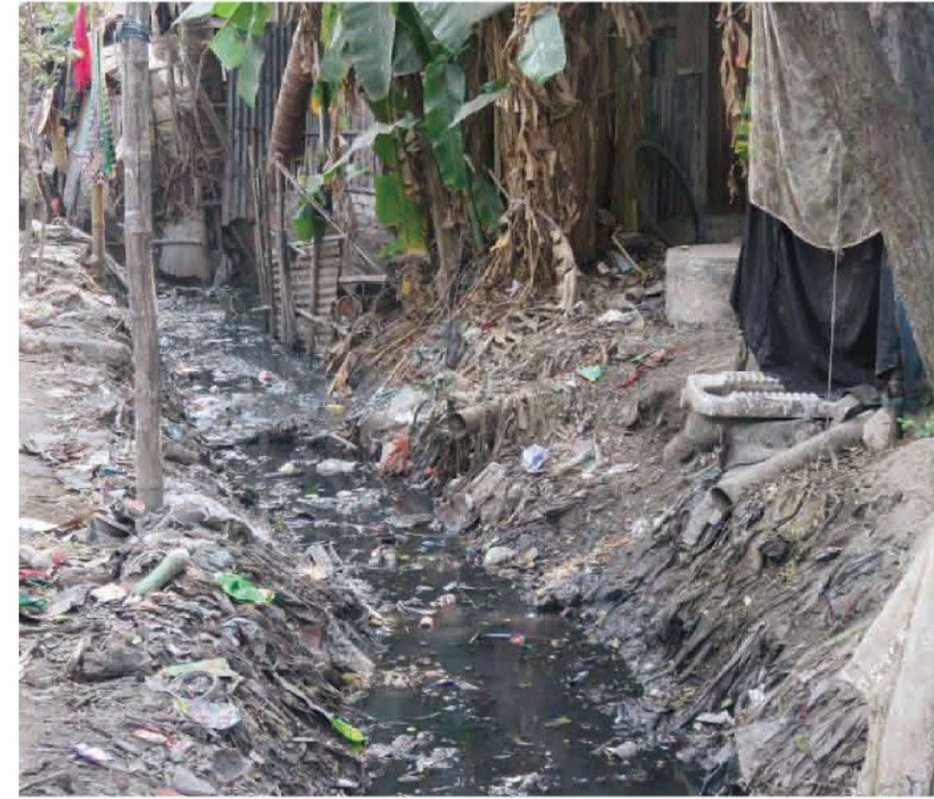
写真-5 クルナ市スラム街における排水処理システムの未整備
